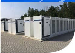
上海金桥储能项目 600kW/1.29MWh 削峰填谷，减少用电成本
